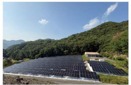
発電容量 514kW の太陽光パネル
