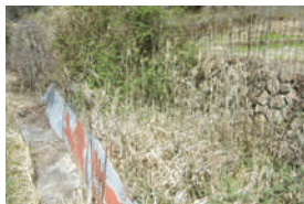
管理不良で放置された河川
