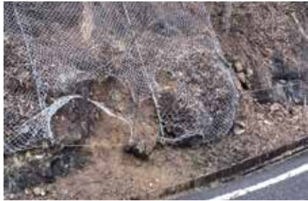
老朽化した落石防止ネット
