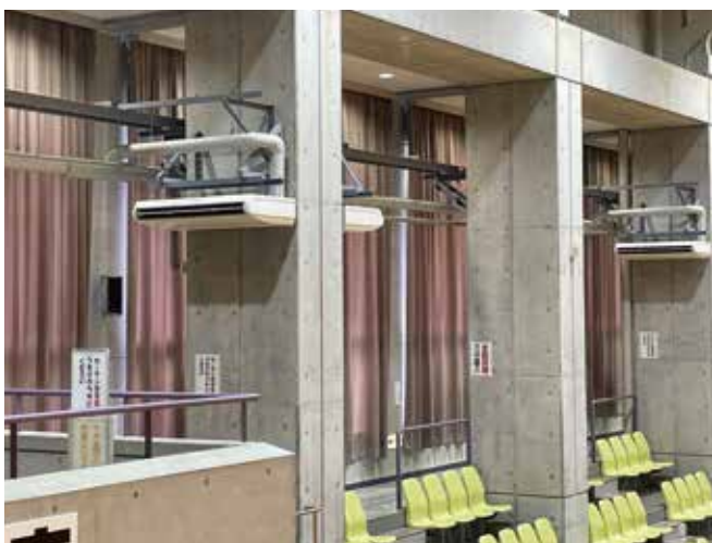
町体育館メインアリーナへ設置された空調設備
