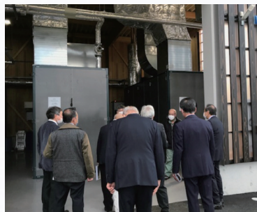
内子龍王バイオマス発電所
