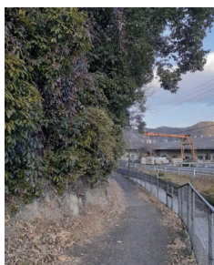
木々がせり出している道路
