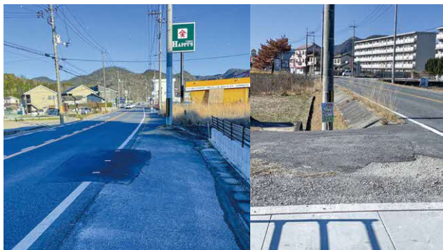
昨年12月に老朽化で水道管本管が破裂し、水道管布設が協議されている国道374号(衣笠地内)
