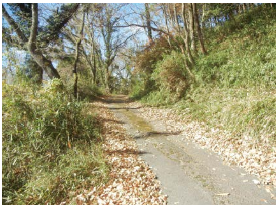
管理に苦慮している町道
