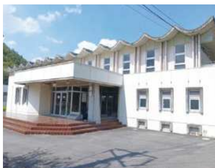
老朽化が著しい町武道館
